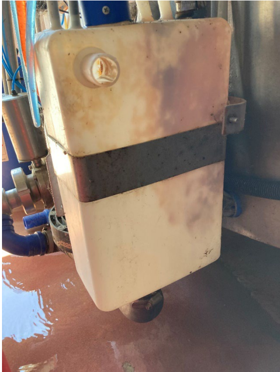
Foto 18: Spoelbak met melkresten die duidelijk zichtbaar zijn.
