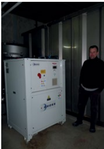
Afbeelding 16. Warmtepomp met buffervat
