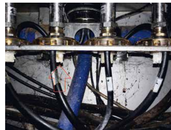
▲ Foto 2: Verstopte luchtgaatjes kunnen leiden tot mislukte aansluitingen. De ventielen zoals aangegeven op de foto dienen daarom steeds gecontroleerd te worden op verstoppingen. Het is aan te raden om deze regelmatig te reinigen.
